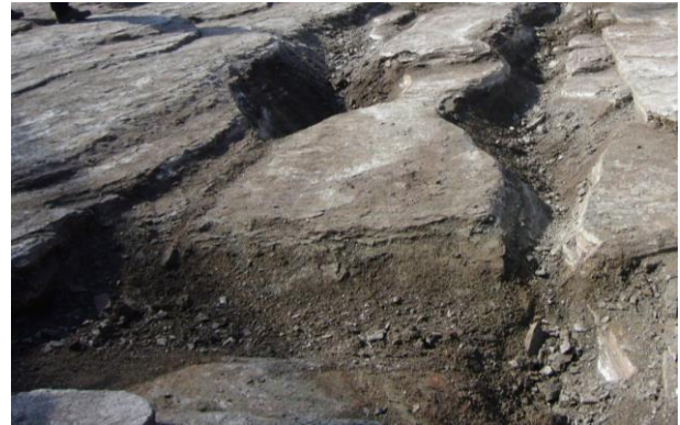
Bild 4: Hochgebrochener Erdfall im Gleiskörper der S-Bahn-Strecke Stuttgart-Korntal
