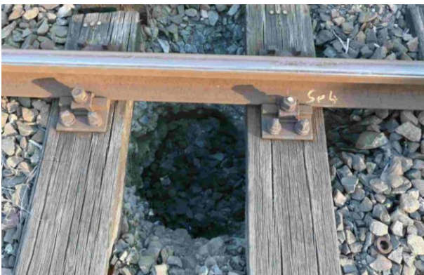
Bild 3: Hochgebrochener Erdfall im Gleiskörper der S-Bahn-Strecke Stuttgart-Korntal
